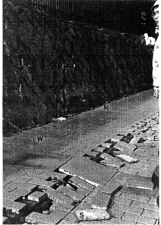
Levha 8. Stewayama /ayırar atımları/uladı dolay, oluşan sıkışma, ve açılma olguları ile ilgili görünüş (Kobe - Şehri Kitano semti).
