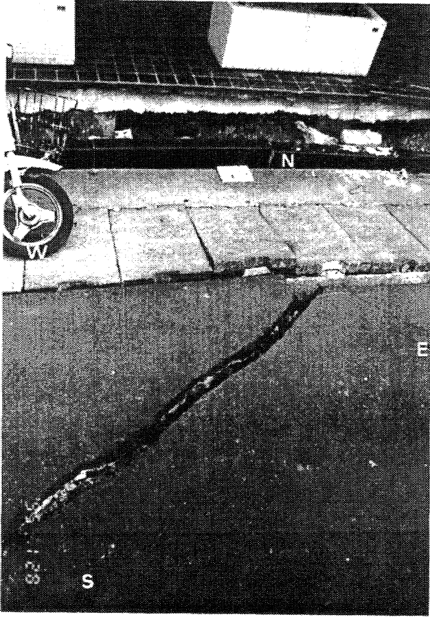
Levha 9. Suwayama ve Nunobiki faylarının atımlarından dolayı oluşan sıkışma ve açılma olguları ile ilgili görünümü (Kobe Şehrinin Sannomiya semti).
